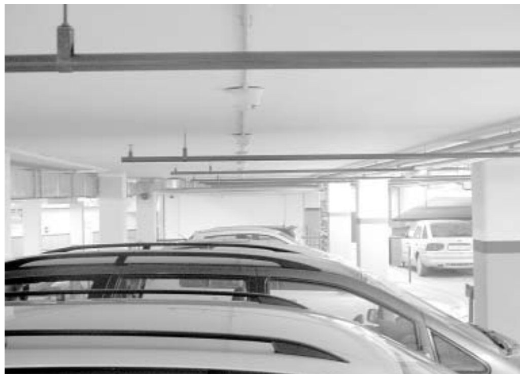
Sve javne podzemne garaže imaju protupožarne sustave
